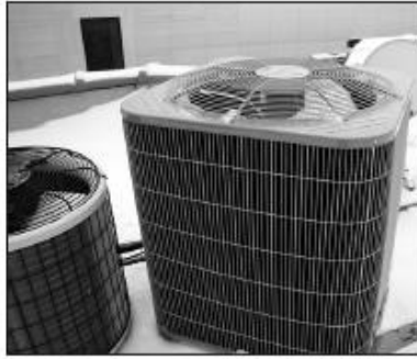
Hava soğutma sistemleri
